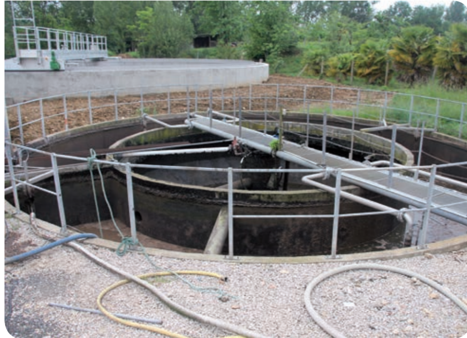
Au premier plan, ancienne station déconnectée et à l'arrière le clarificateur, dernière étape avant rejet de l'eau traitée vers le milieu naturel.
