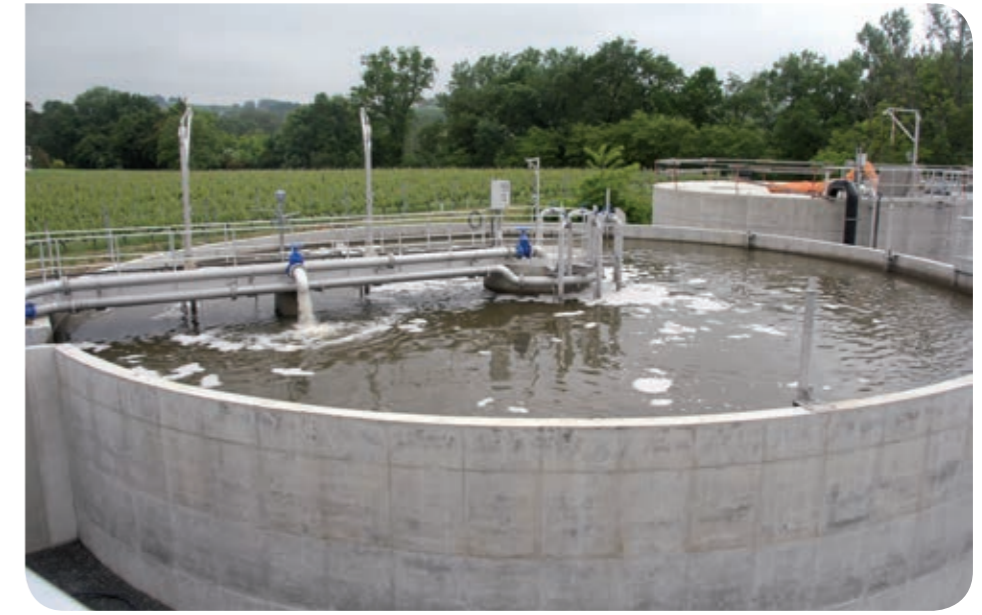
Au premier plan bassin d'aération, en arrière silo à boue et le clarificateur.
